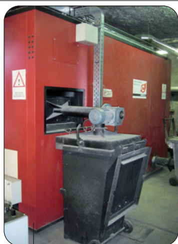
La chaudière Compte de 700 kW et la benne à cendres
