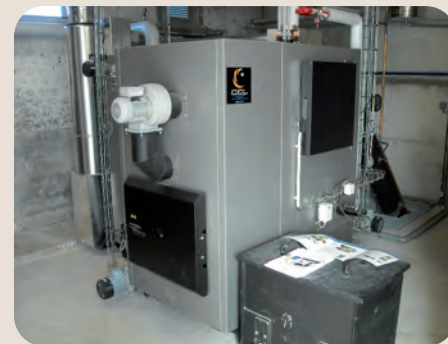
La chaudière de 220 kW (photos Biomasse Normandie)
