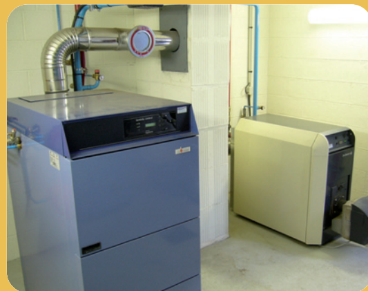
Les chaudières (bois à gauche et fioul à droite)
