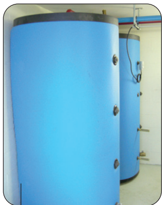
Les ballons d'hydro-accumulation
