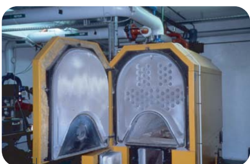
La chaudière Köb
