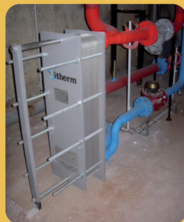
Sous-station à échangeur à plaques
