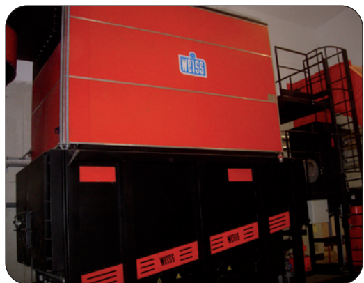
La chaudière Weiss de 2,5 MW
