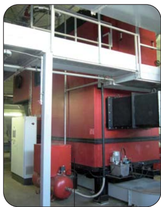
La chaudière de 2 700 kW
