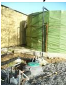
Photo 1 : Cuve de stockage des jus
