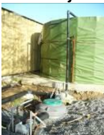
Photo 1 : Cuve de stockage des jus
