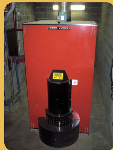
La nouvelle chaudière (Energie Système)
