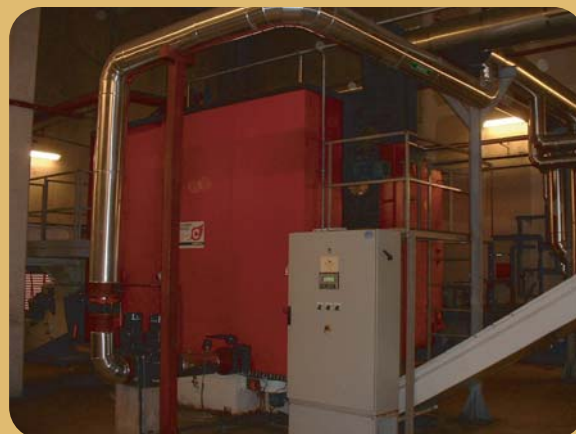
Chaudière COMPTE 1,2 MW
