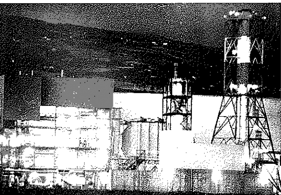
Production d'énergie à partir de biomasse et de combustible fossile (CdF Ingénierie)
