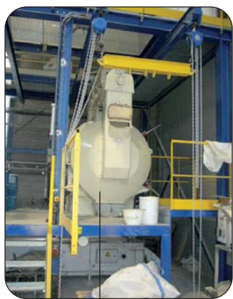
L'unité de granulation de l'entreprise Aswood à Bouleville (27)
