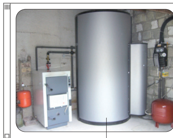
Chaudière bûches et ballon d'hydro-accumulation
